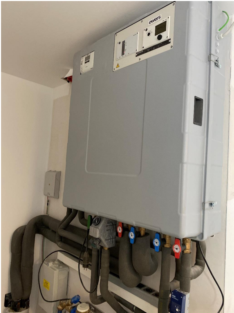
Bild 3: Meine Übergabestation an der Wismarer Str.
